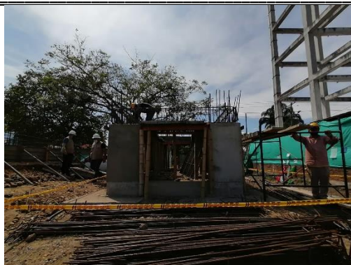
Tanque de aireación
