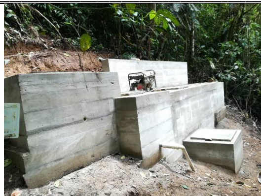
Foto Desarenador del Acueducto Interveredal Argelia
