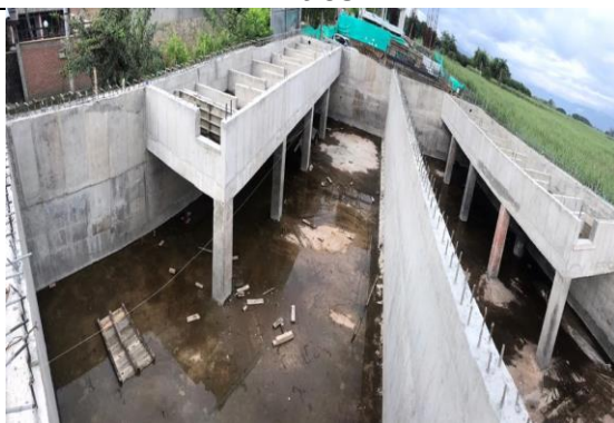
Tanque de cloración
